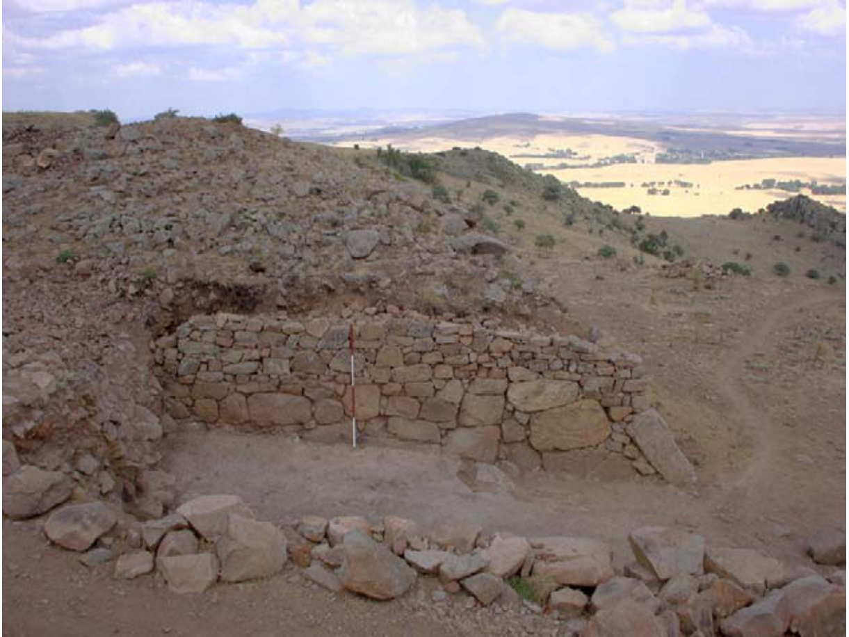
Şekil 82. Kapı iç geçidinin güneydoğu duvarı. Taş kaplı eğimli yüzey ile kule arasındaki derz, gevşek molozu tutmak için yerleştirilen yeni taşların üzerinde açıkça görülmektedir. 1999 yılında üzerinde grafiti bulunan kum taşı bloklar, zarar görmelerini engellemek amacıyla dış köşede buldukları yerden alınmışlardır. Bunların yerlerine konulabilecek yeni kum taşı bloklar kesilmesi düşünülmektedir. (03dpjv6752)
