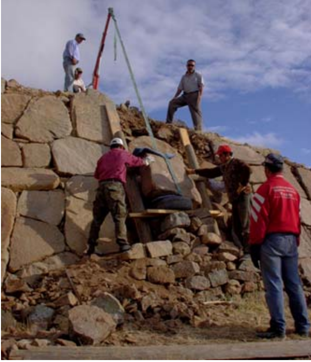
Şekil 79. Taş kaplı eğimli yüzeyden düşen büyük taşların yerine konmasında bir vinç kullanılmıştır. Bu çalışmayı, Bakanlık Temsilcimiz Mehmet Katkat ustalıkla yönetmiştir. (03dpjv5616)
