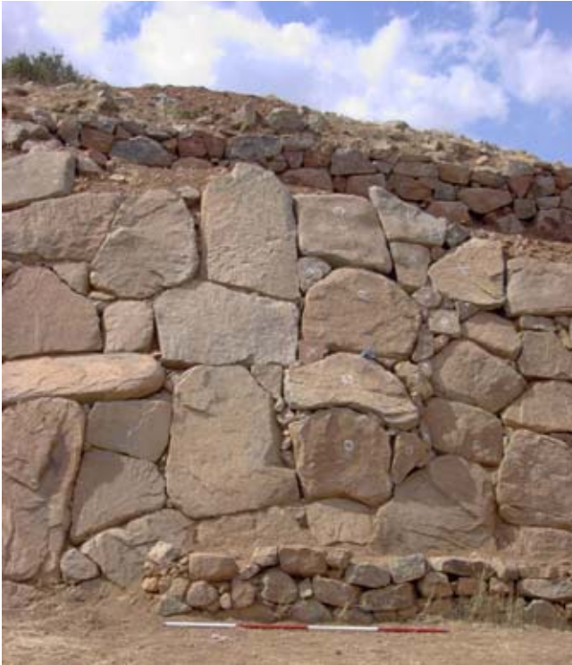
Şekil 80. Koruma-onarım çalışmalarının tamamlanmasının ardından taş kaplı eğimli yüzey ile arkasındaki kule duvarı. Hangi taşların yerine konulduğu ve hangi kısımlara yeni taşlar yerleştirildiği konusunda detaylı bir kayıt tutulmuştur. (03dpjv6753)
