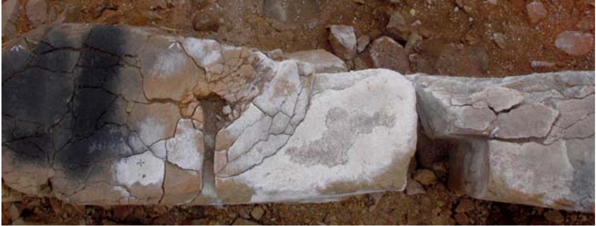
Şekil 17. Güney Kulesindeki duvarda yer alan bir kumtaşı bloğun dışındaki bir kare oyuk muhtemelen dikey bir hatlı ya da zemin girişinin yeri idi. Soldaki kenet deliği belki de tahtadan kenet bloğu zemin girişine tutturmaya yaramaktaydı. Yumuşak kumtaşı yangından dolayı paramparça olmuş ve tuzla kaplanmıştı. (04dpjv2848)
