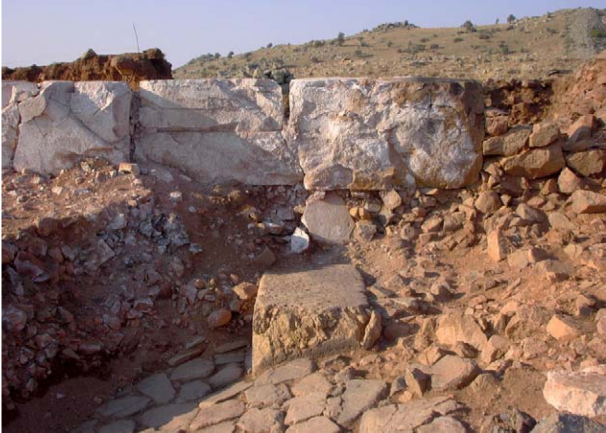
Şekil 16. Güney Kulesinin kuzey duvarı büyük blokların arasındaki yatay ahşap hatılların yanmasından dolayı yapısal olarak dengesizdir. İnsitu olarak kesilmiş ve granit döşemenin içine yerleştirilmiş büyük konglomera sütun tabanı aslan ya da sfenks için altlık olmalıdır. (04dpjv2512)
