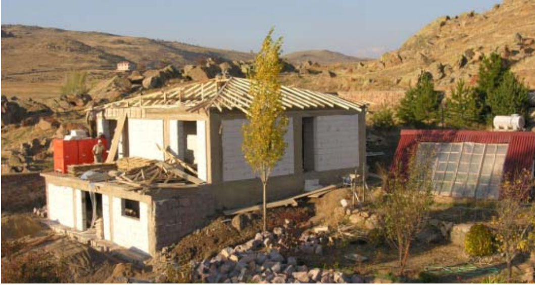
Şekil 5. Araştırma ve eğitim amaçlı Erdoğan Akdağ Merkezi'nin inşaatı. AAC blokları, çimento, kum ve çatı kaplaması sırasıyla AKG Gazbeton, YL Yozgat Çimento, Sorgun Belediyesi ve Onduline tarafından bağışlanmıştır. (05kenc0628)
