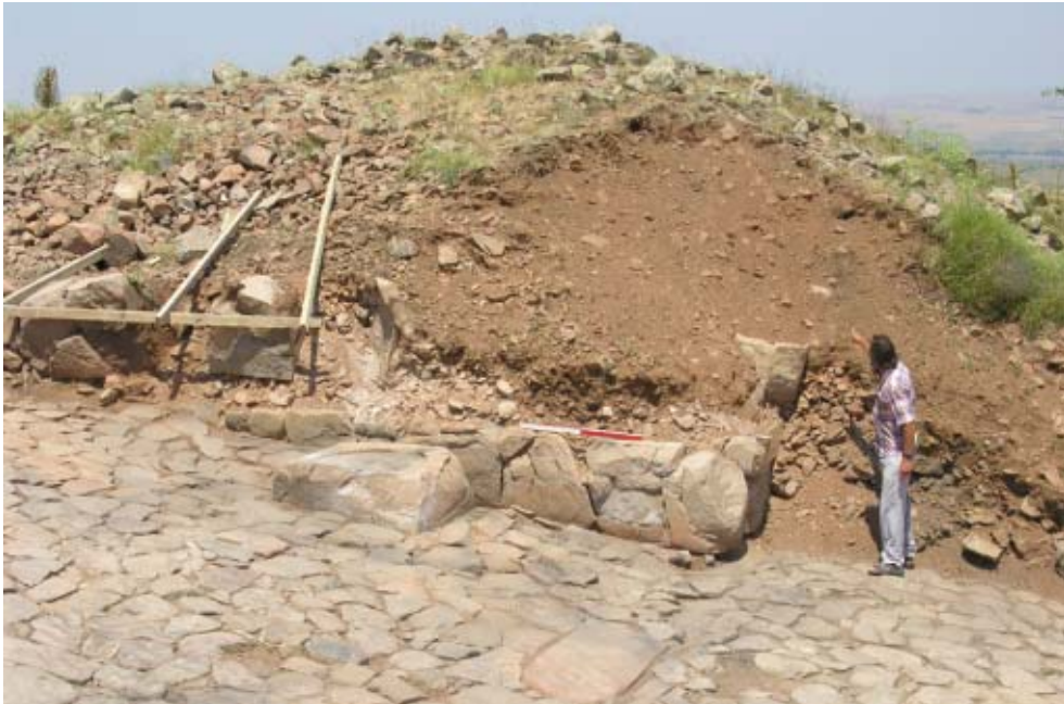
Şekil 26. Kuzey Kulesi'nde üst sıraları oluşturan büyük ve parçalanmış granit bloklar yerinden oynatarak dökülmüştür. Görülen dikme kaidesi 2003 yılında ortaya çıkarılmıştır. (05dpnc0964)
