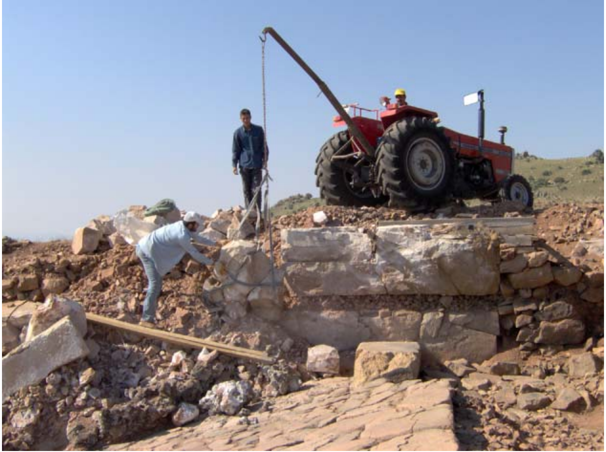
Şekil 24. Taşların arasındaki yatay kirişin yanması ile oluşan boşluk Güney Kulesi'ne ait duvarın yapısal açıdan dengesini yitirmesine neden olmuştur. Cephe kaplamasını oluşturan taş bloklar ve yanmış moloz, doğal olarak beyaz karbonatlarla kaplı halde bulunmuştur. Yangının şiddeti ile parçalanmış çok büyük bir blok güvenlik sebebi ile kaldırılmıştır. (05dphp1104)
