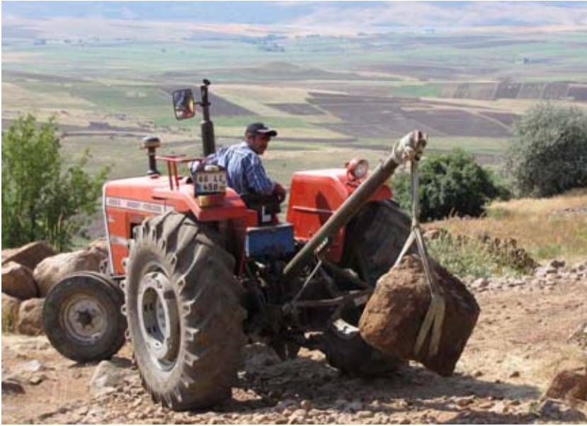
Şekil 28. Döküntü taşların bir kısmı restorasyon sırasında yeniden kullanılmak üzere bir kenara ayrıldı. (09dpcp0233)
