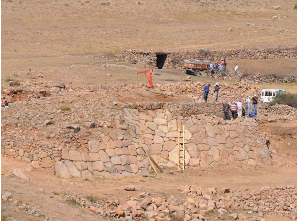
Şekil 130. Taş kaplı şevi restore etmek için, kapı yapısı civarından daha önce temizlenerek atılan taşlar kullanılmıştır. (10dpnd1121)
