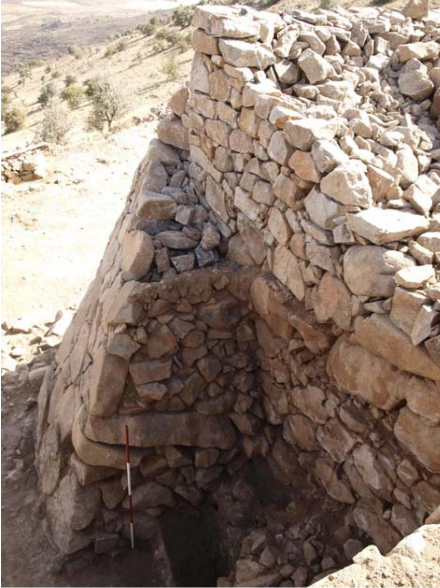
Şekil 118. Taş kaplı şevin inşa evreleri, enlemesine duran bir taş ile ikiye bölünmüştür. Neredeyse dik çalışma yüzeyi, hiç şüphesiz taş kaplı şevin çökmesinde rol oynamıştır. Yemek artıkları ve kırık pişirme kapları içeren çöp bu korunaklı köşede biriktirilmiştir. En üst taş sırası günümüzde yeniden inşa edilmiştir. (10dpkc2156)
