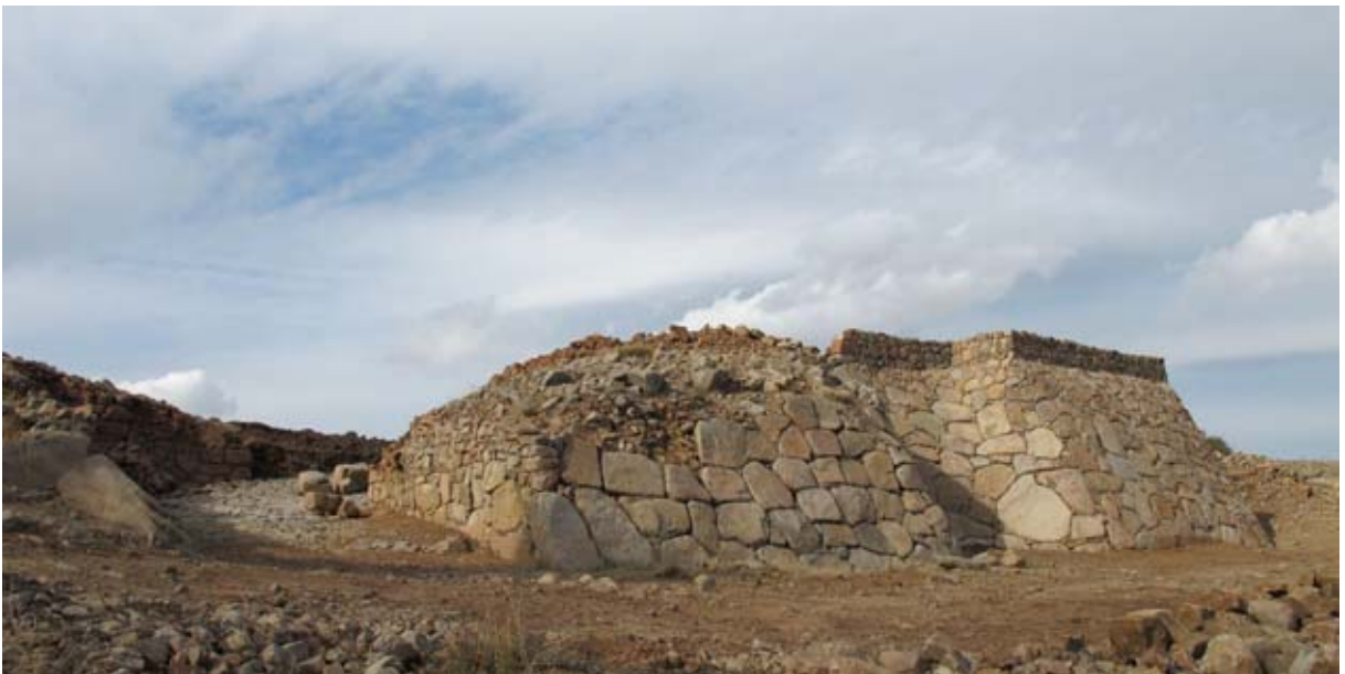
Şekil 127. Ekim 2010da restorasyon çalışmaları sonrası fotoğraflanan Kapadokya Kapısı'nın taş kaplı şevi. (10dpcg0933)
