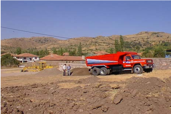
Yeni binanın temelleri Ağustos 2000'de atılmış, ancak daha sonra inşaatına 2001 baharında devam edilmesi uygun görülmüştür.
