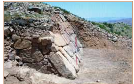
Figure 14: East side of the gate passage, tower and rubble from the destroyed upper wall. Şekil 14: Kapı geçidinin doğu yüzü. Resimde burç ile yıkılan duvar üst yapısına ait taş döküntüleri görülebilmektedir.
